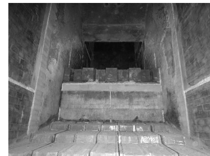
更新後の東清掃センター1号焼却炉
