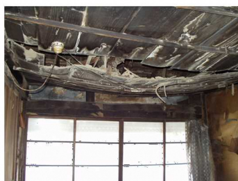
2階天井損傷状況
