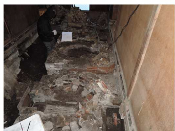
炊事場カマドの 損傷状況
