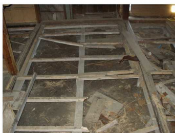
土台損傷状況
