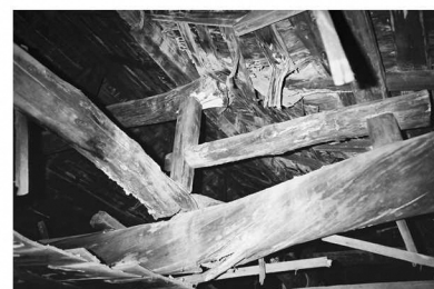
小屋梁損傷状況
