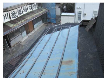
炊事場棟屋根 損傷状況
