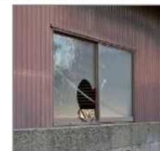
窓が割れた管理不全空家
