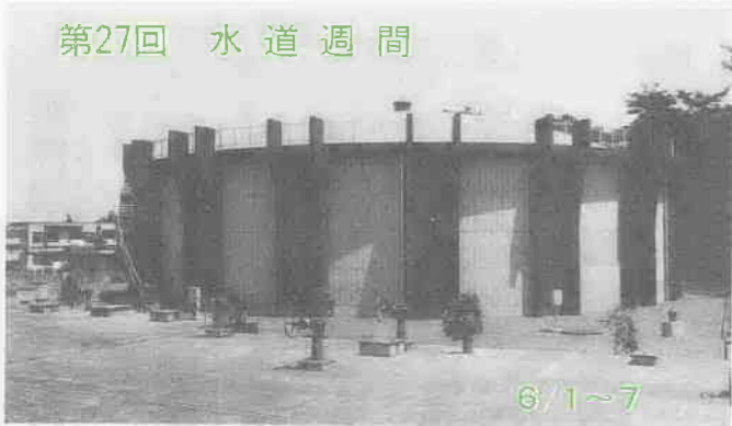
霞ヶ関第二浄水場に増設された地上式タンク
