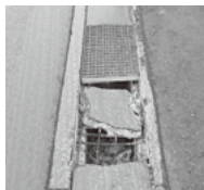
側溝蓋が割れている
