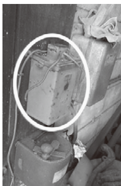
ポンプ小屋の低圧相コンデンサー
