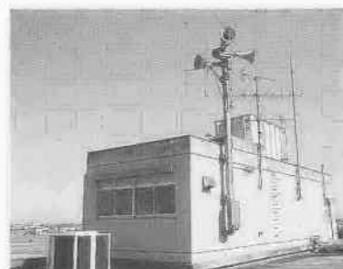
砂中学校の校舎屋上に設置されている防災行政無線
