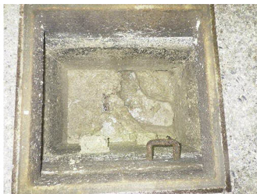
ラード等堆積状況（人孔内点検）
