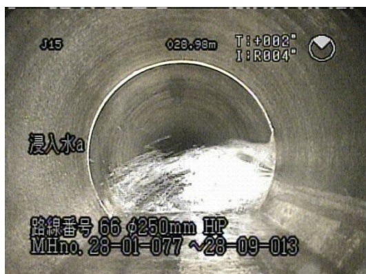
継手からの地下水の流入（管内調査）
