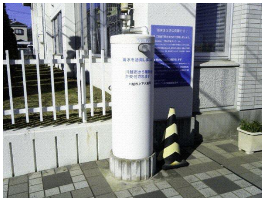
雨水小型貯留施設
