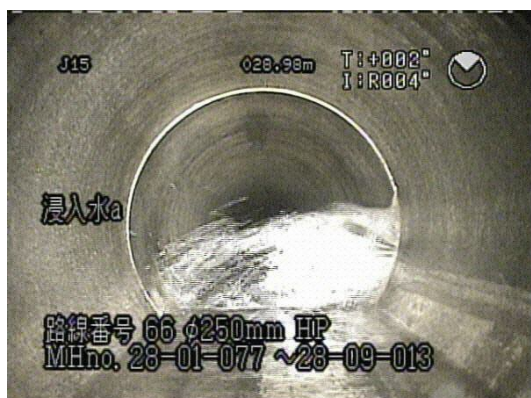
継手からの地下水の流入（管内調査）
