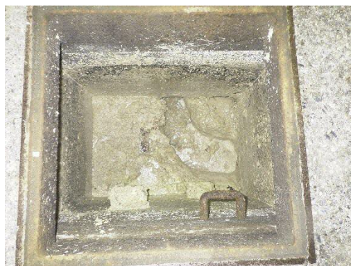
ラード等堆積状況（人孔内点検）
