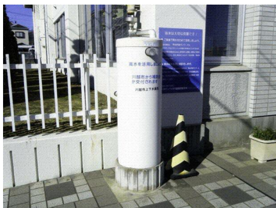
雨水小型貯留施設
