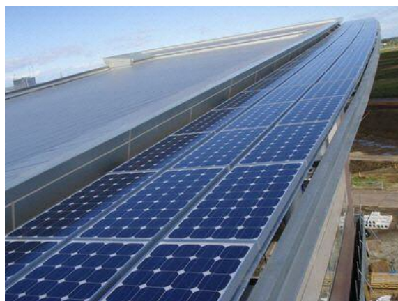
環境プラザ「つばさ館」(庇部分) 18.0kW
