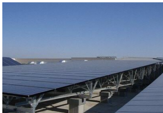
環境プラザ「つばさ館」(陸屋根型) 58.9kW
