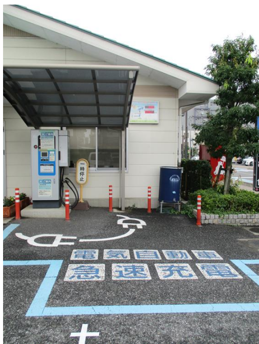
<電気自動車急速充電器>
