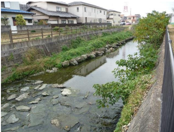
河床には礫や土砂が堆積している
