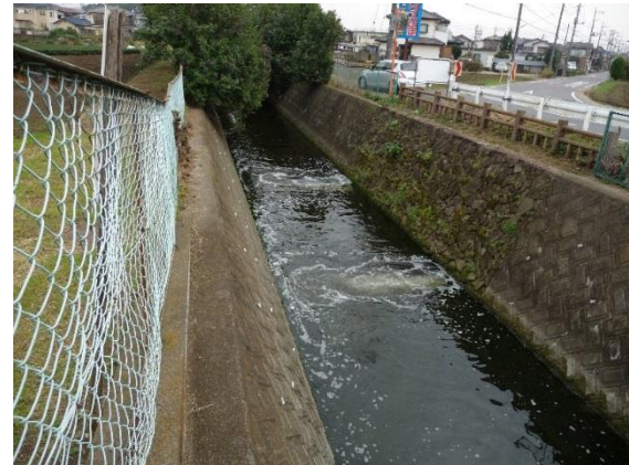
還流水が供給されている
