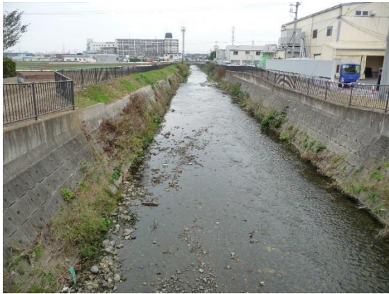
河床には礫や土砂が堆積している
