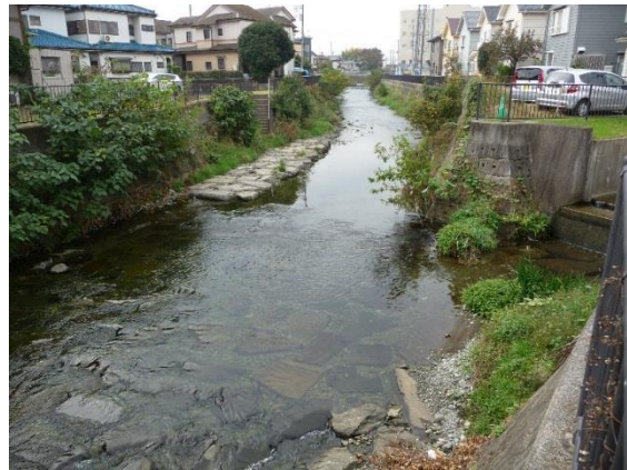
河床には礫や土砂が堆積している
