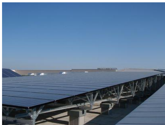
環境プラザ「つばさ館」(陸屋根型) 58.9kW
