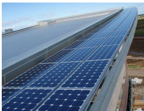
環境プラザ「つばさ館」(庇部分) 18.0kW
