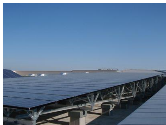
環境プラザ「つばさ館」(陸屋根型) 58.9kW
