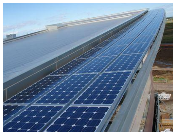
環境プラザ「つばさ館」(庇部分) 18.0kW
