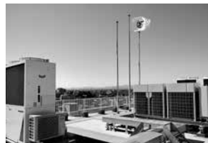
新たに本庁舎に設置した空調設備
