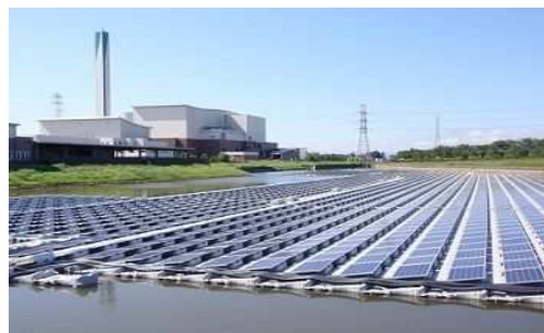
資源化センター第一調整池に設置された 大規模太陽光発電システム
