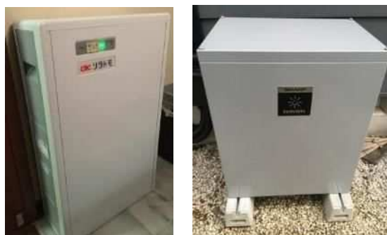
蓄電池設置住宅
