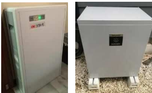
蓄電池設置住宅
