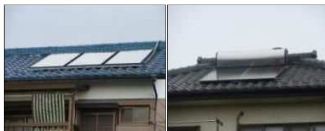
ソーラーシステム設置住宅 太陽熱温水器設置住宅
