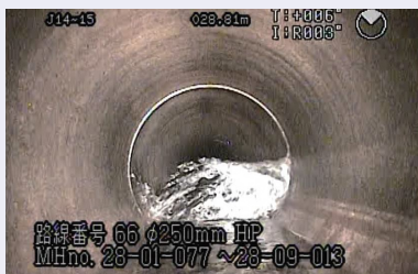
▲劣化した管の継手部分から浸入する水
