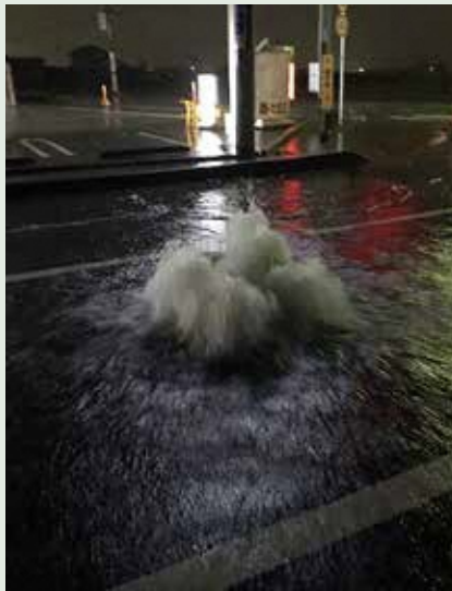
▲マンホールから汚水があふれる様子
