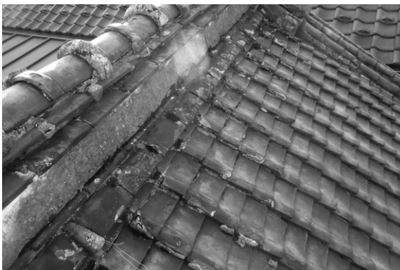
修理前（損傷箇所）
