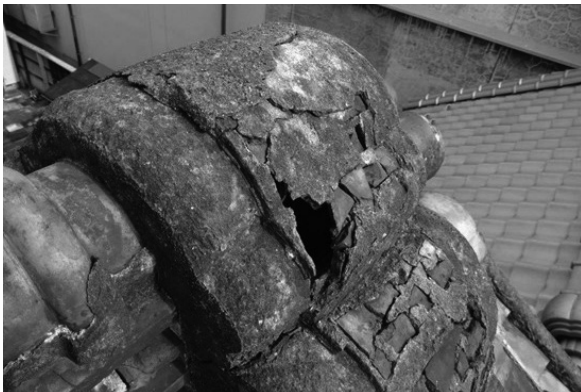
修理前（損傷箇所）
