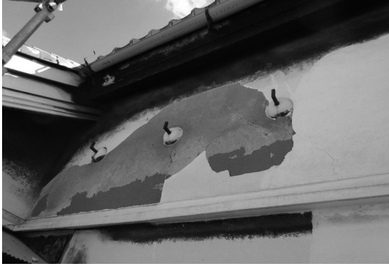
修理前（損傷箇所）
