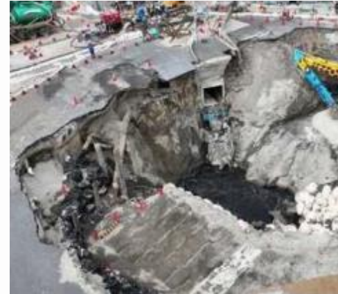
図1：埼玉県八潮市で発生した道路陥没事故の様子
