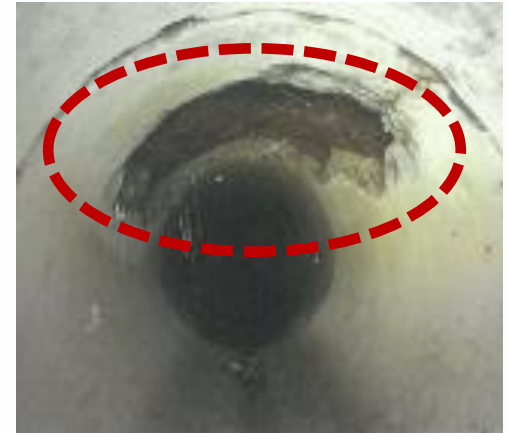
図2：川越市の点検で確認された下水道管きよ内のクラック
