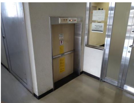
庁舎分室ダムウェーター(小荷物専用昇降機) ※1基設置
