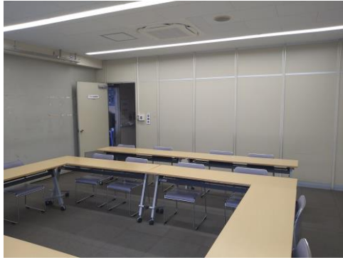
執務スペースを転用した会議室(本庁舎3階) ※仕切り壁の防音性に課題あり
