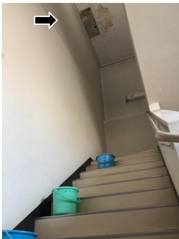
雨漏り状況／遠景(庁舎分室 3 階・塔屋) ※屋上から階段室に雨漏り
