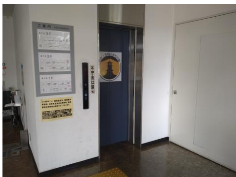
東庁舎エレベーター ※1基設置
