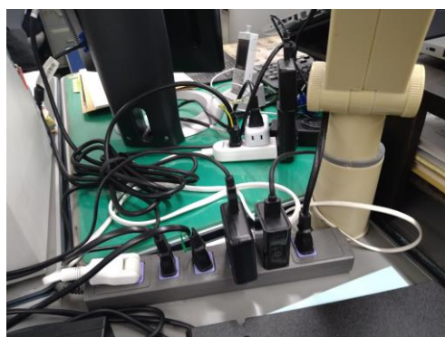
コンセント状況(本庁舎4階) ※PC・電話機・モニターを接続(4名分)
