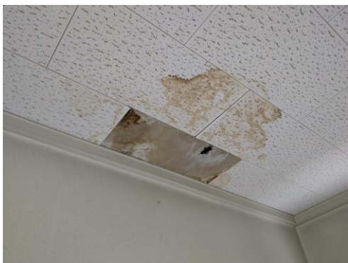
雨漏り状況／近景(庁舎分室 3 階・塔屋) ※屋上から階段室に雨漏り
