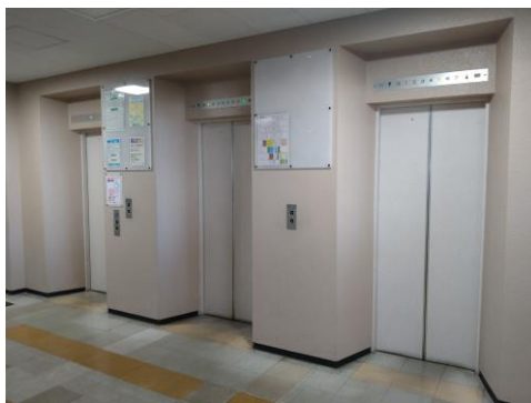
本庁舎エレベーター ※3基設置
