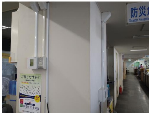
改修後の各種配線(本庁舎 4 階) ※柱に空調操作盤や電源等を後付け
