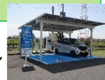
充電ステーション
