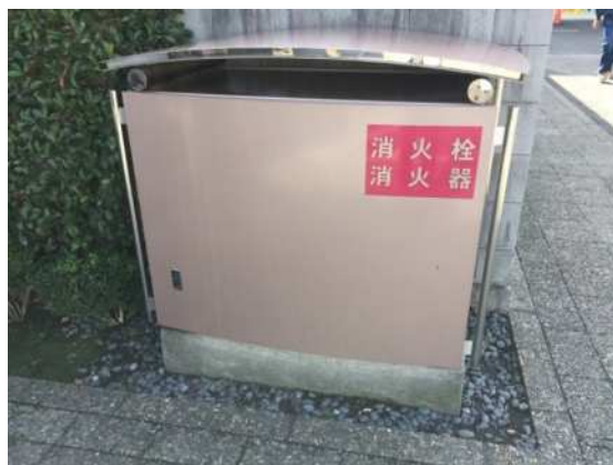
簡易型屋外消火栓
