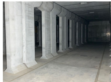
藤原町第一公園地下にある 雨水貯留施設
