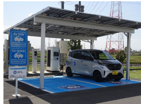
電気自動車となぐわし公園のEV充電スポット
