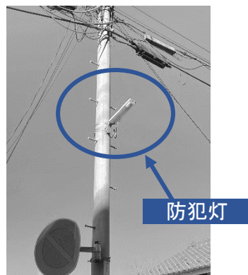
防犯灯の設置例
