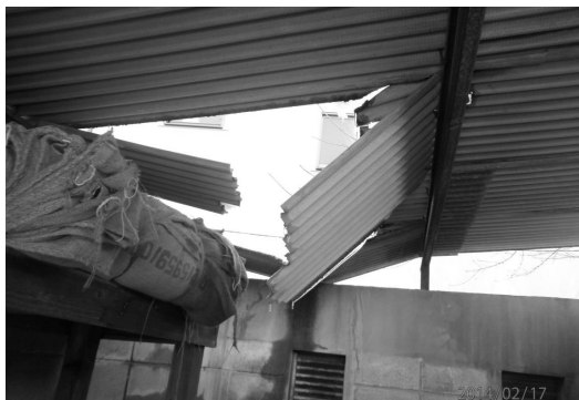
平成 26（2014）年 2 月大雪被害 （落雪で屋根が抜けた倉庫）
