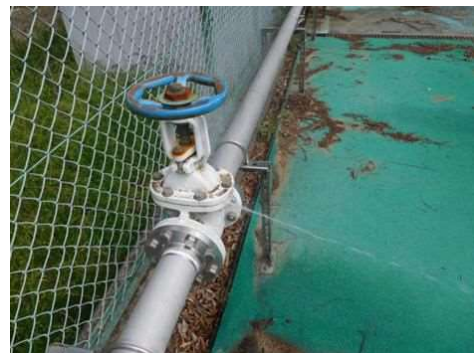
給排水設備 ※配管からの漏水
