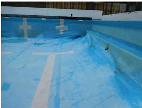
プール槽 ※防水シートの亀裂、浮き。
