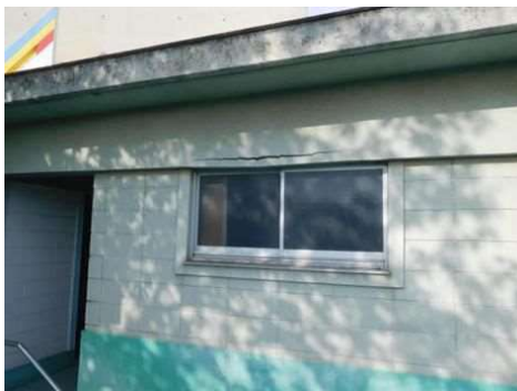
付属棟 ※外壁のひび割れ、塗装の剥がれ
