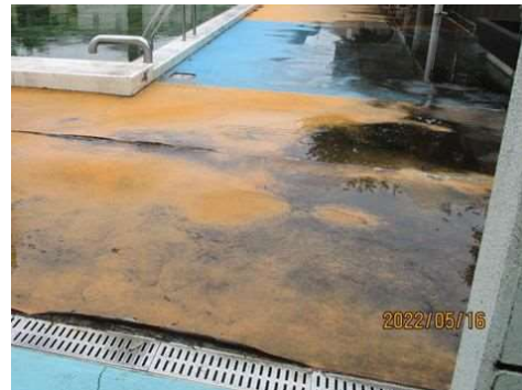
プールサイド ※シートの亀裂、剥がれ
