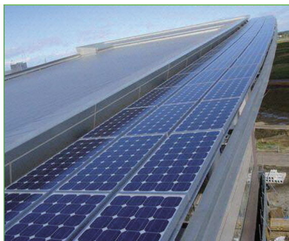
環境プラザ「つばさ館」(庇部分) 18.0kW
