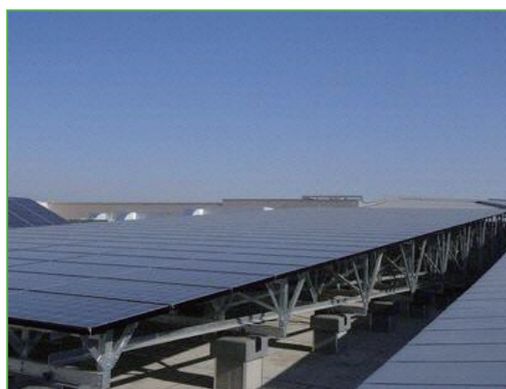
環境プラザ「つばさ館」(陸屋根型) 58.9kW
