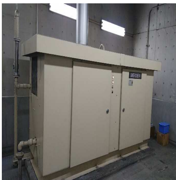
非常用自家発電装置
