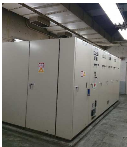
変電設備（変圧器）
