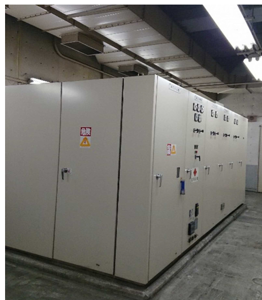
変電設備（変圧器）
