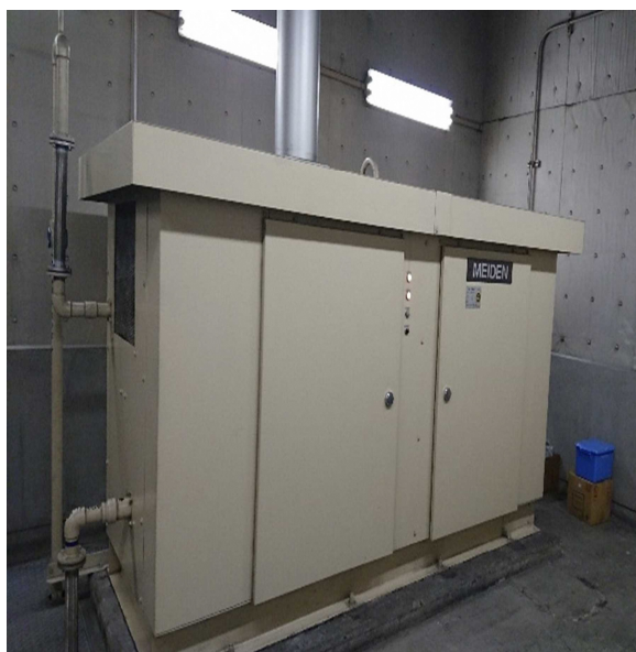
非常用自家発電装置
