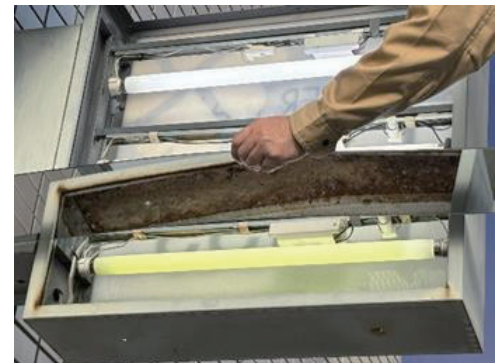
広告板底部の全体にさびが生じていた事例
