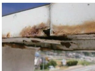
広告板側部のさび
