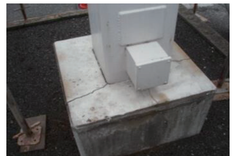
基礎部にひび割れが生じていた事例
