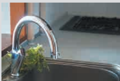
蛇口の水漏れ
