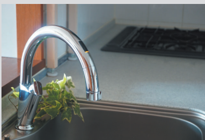
蛇口の水漏れ
