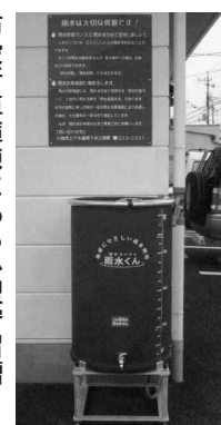
市役所車庫棟にある小型貯留槽
