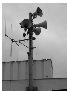
上戸小学校の屋上に設置されている固定系無線局
