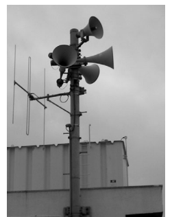
上戸小学校の屋上に設置されている固定系無線局
