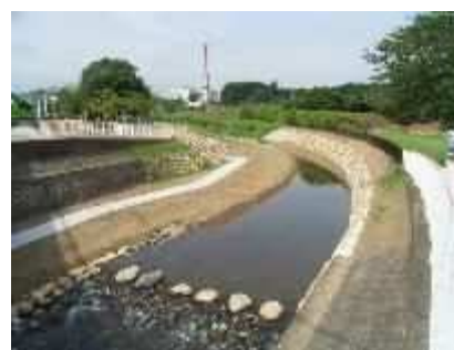
多自然型護岸(笠幡地区)
