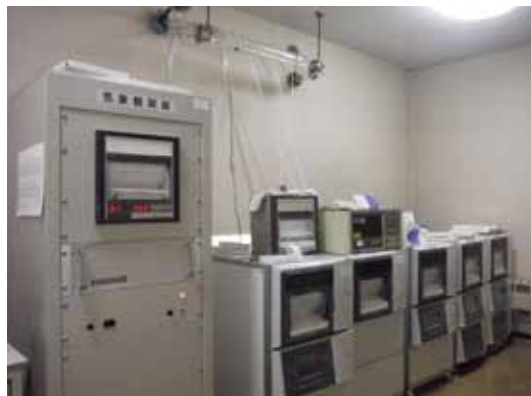
■大気汚染常時監視測定局の内部
