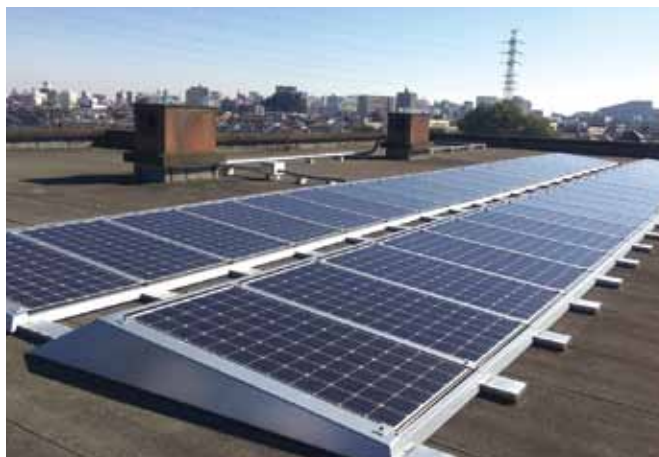
■学校屋上の太陽光発電システム
