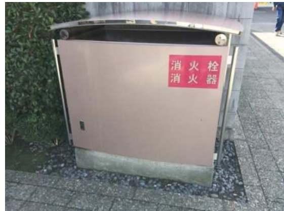
簡易型屋外消火栓
