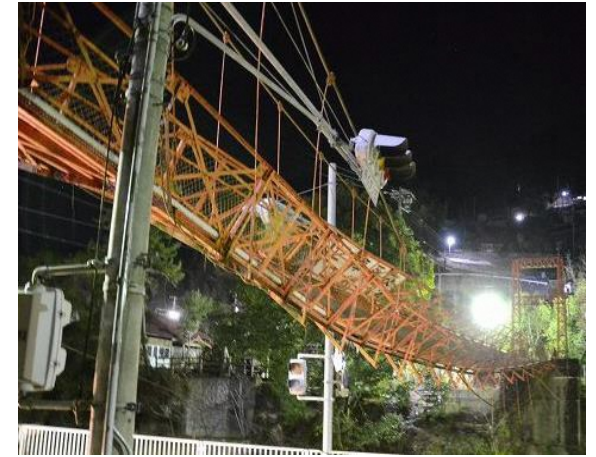
吊り橋ワイヤー破断
