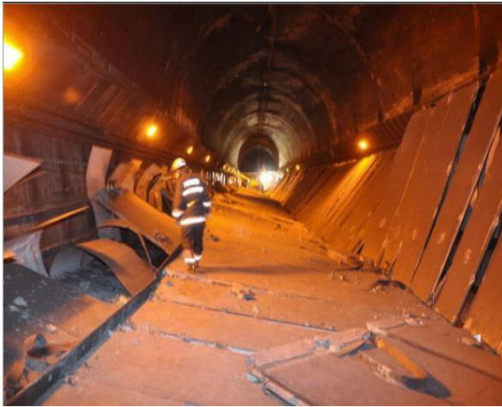
トンネル天井板落下
