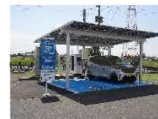
電気自動車用充電ステーション
