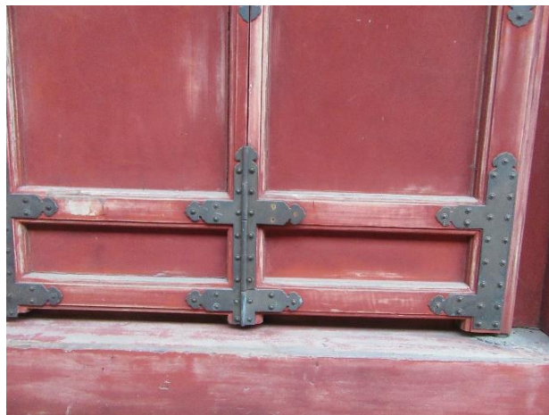
修理前 正面棧唐戸の化粧釘の脱落
