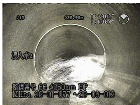
継手からの地下水の流入（管内調査）
