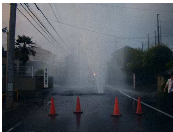
2008 年 8 月の漏水状況
