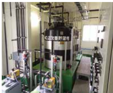
消毒設備 (しょうどくせつび) 地下水を消毒して水道水にします
