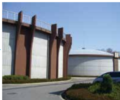
配水池 (はいすいち) 浄水場内の配水池にためます
