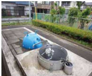
取水井 (しゅすいせい) 地下から水を汲み上げます
