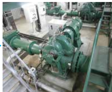
配水ポンプ (はいすいぽんぷ) 配水池の水をみなさんのご家庭までお届けしています
