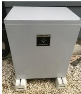
蓄電池設置住宅
