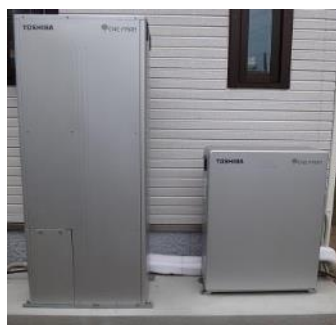
エネファーム設置住宅
