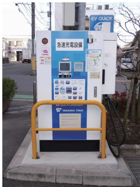
市庁舎北側電気自動車充電器
