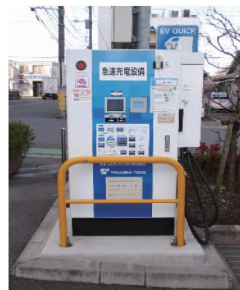
市庁舎北側電気自動車充電器
