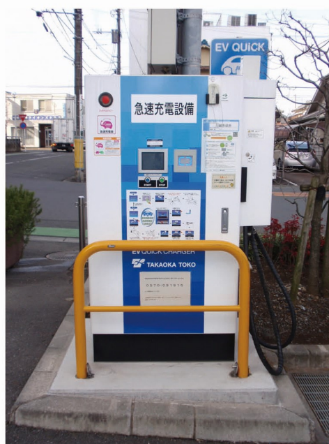
市庁舎北側電気自動車充電器
