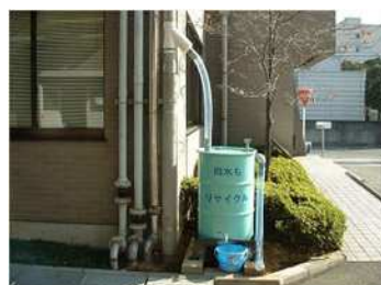
雨水利用(東清掃センター)
